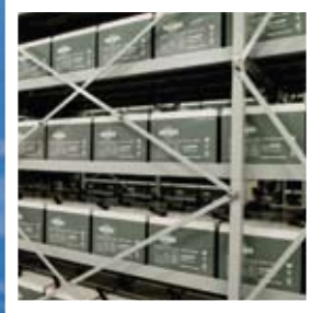
1400kW batterijopstelling autonomietijd: 4 minuten Datacenter Amsterdam
